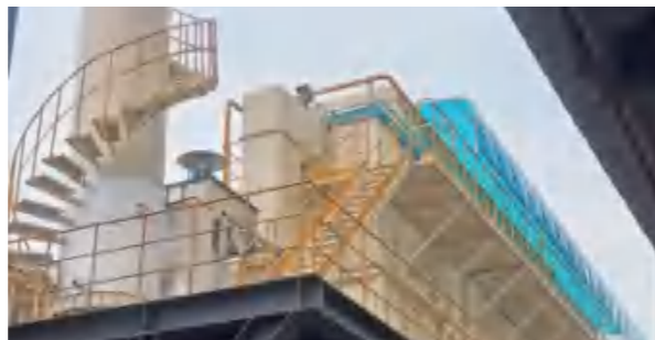
公司所属中铁九桥引入蓄热式催化燃烧 (RTO) 有机废气治理设备、 粉尘处理设备, 有效减少了挥发性有机物的排放
