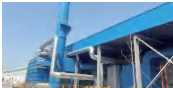
公司所属中铁宝桥旗下舟山公司在打砂涂装车间 安装沸石转轮+RTO 装置
